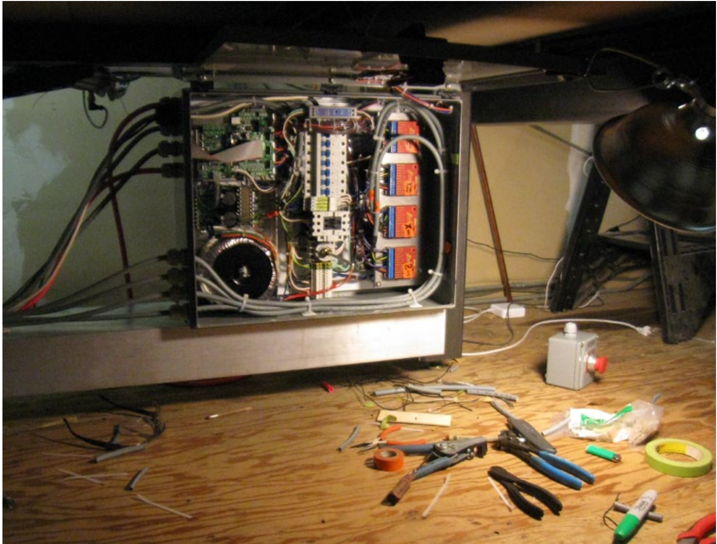
fig.0058 control box wiring.JPG
