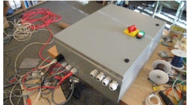
fig.0057 control box wiring.jpg
